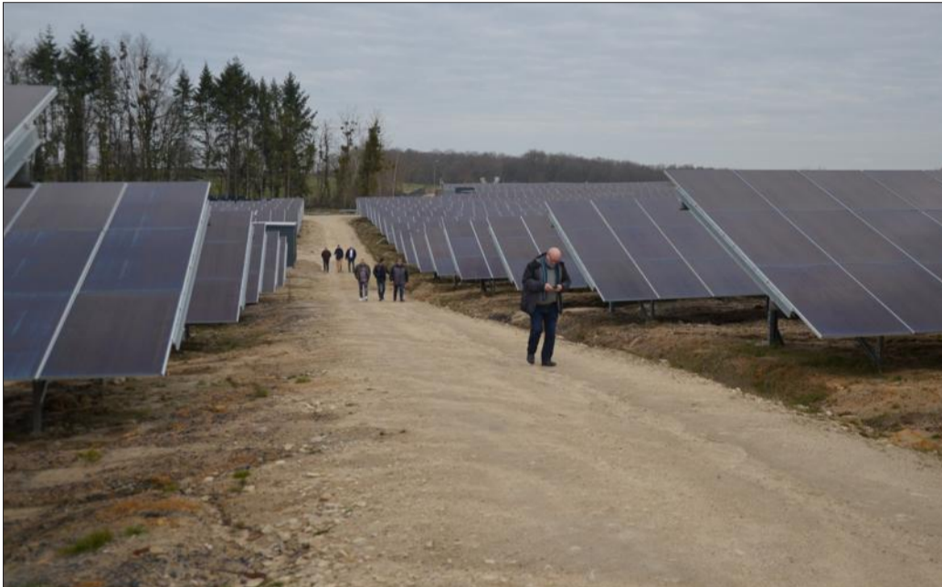
La centrale solaire de Sanvignes s'étend sur 14 hectares et compte 28 000 cellules photovoltaïques.
